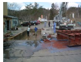
トラックスケールの清掃
